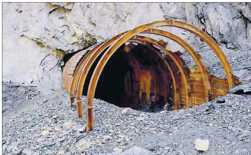
Die Baustelle in der Saltinaschlucht wurde nie wirklich aufgeräumt.
