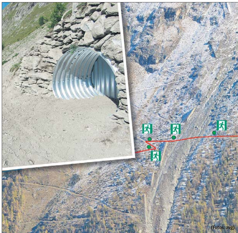
Ein steinschlaggefährdeter Abschnitt des Europawegs ist neu mit Unterständen (kl. Bild) gesichert.
