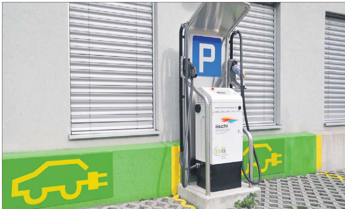
Die Gleichstromtankstelle bei der EnBag in Gamsen.
