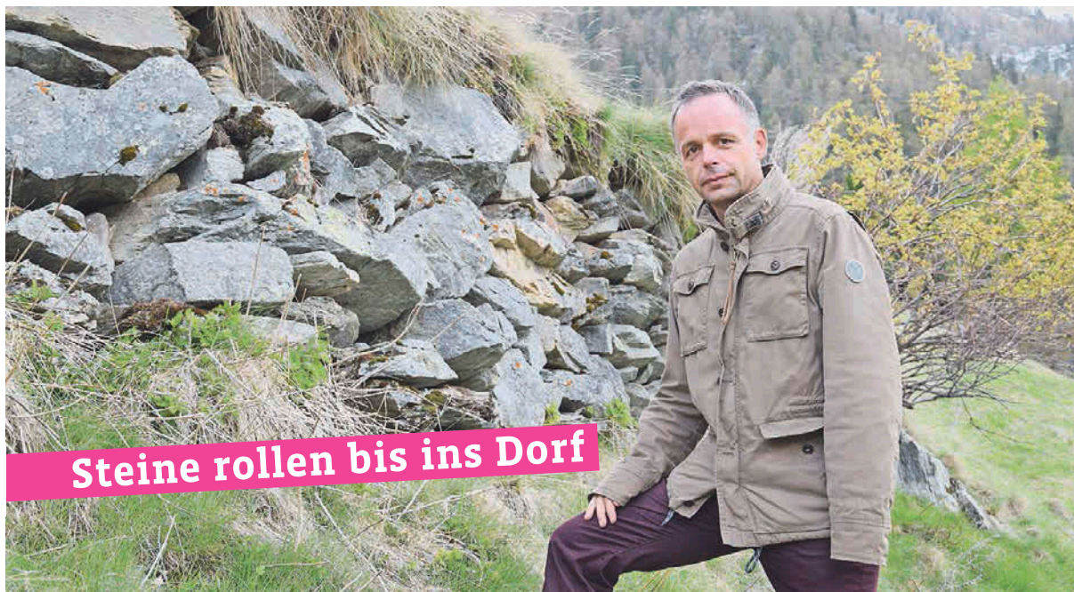
Der Täschener Gemeindepräsident Mario Fuchs sorgt sich um die verfallenen Trockensteinmauern am Täschberg.
