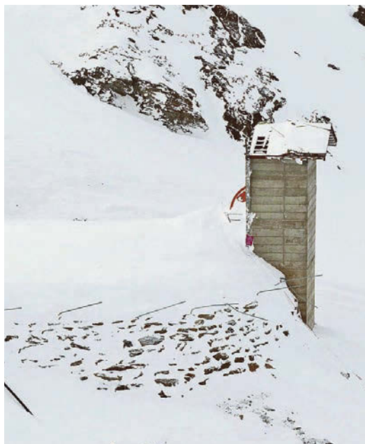
Komplett zerstört: Von der Talstation der «Kummebahn» steht nur noch der hinterste Teil.
