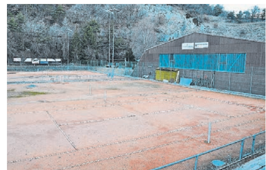
Die Aussenplätze in Visp müssen saniert werden.
